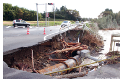
洗掘され水道管が破壊された掘板橋
