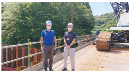
橋脚が破壊された茄子小田橋の架け替え
