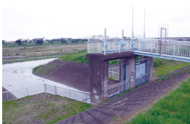
⑰大丸谷戸川の排水樋門
